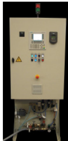
Шкаф управления и дозирующее устройство
